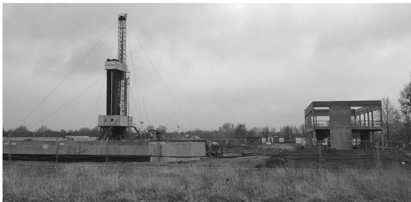
Wiertnia firmy Drilling drążąca otwór, który będzie zasilał nowy zakład w ciepło. Fot. B. Kielbasa
